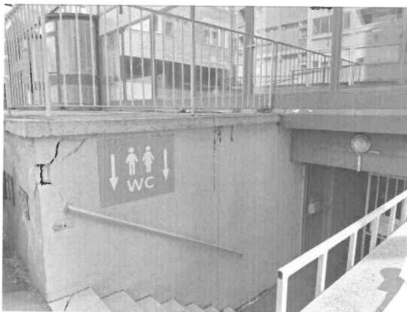
4. fotó: Vízszintes repedés mutatkozik a vakolaton a műköburkolat alatt
